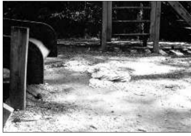
Alcune immagini dell'incuria e del degrado dei parchi di Assisi e Santa Maria degli Angeli. Da sinistra i basamenti di cemento di alcuni giochi fuoriescono dal terreno costituendo un pericolo per i bambini; uno scivolo danneggiato; sporcizia in un'area verde. Le foto sono state scattate da Liana Botti
