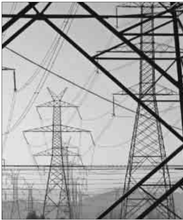
Black out Azienda cita l'Enel per un black out che ha bloccato i cancelli impedendo l'uscita dei camion
