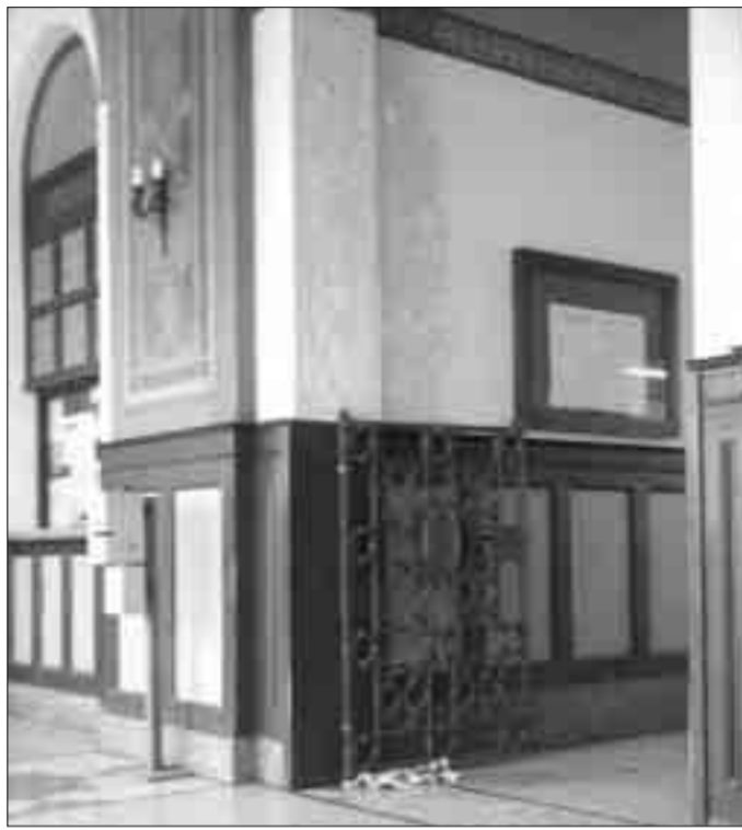
Disagi Altra perdita d'acqua alla stazione ferroviaria
