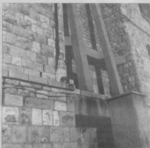
Zona Ivancich Il muro lesionato di una casa
