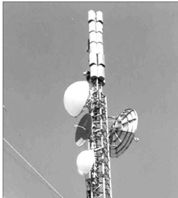
Un'antenna per la telefonia
