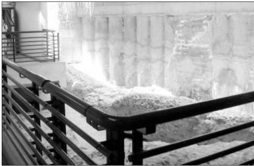
Un'immagine del cantiere inaugurato ieri dall'amministrazione comunale di Assisi. L'intero percorso sarà sorvegliato da telecamere. I lavori dovranno essere portati a termine entro 180 giorni.
